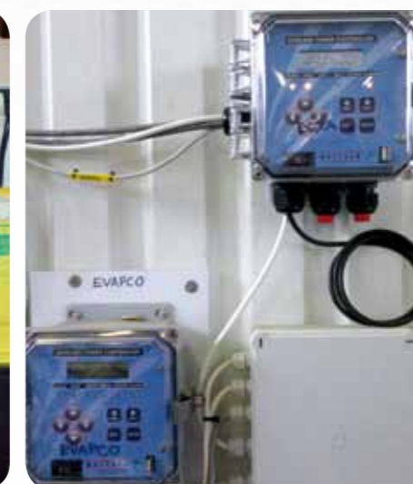
Ásványvíz üzem hűtőtorny-WCT műszer
