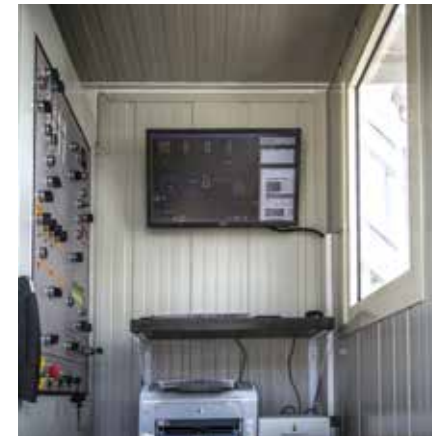
PC-based automation system. Automazione impianto gestita da PC.
