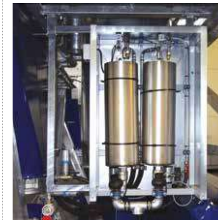
Chemical admixtures dosing devices. Sistema di dosaggio additivi.
