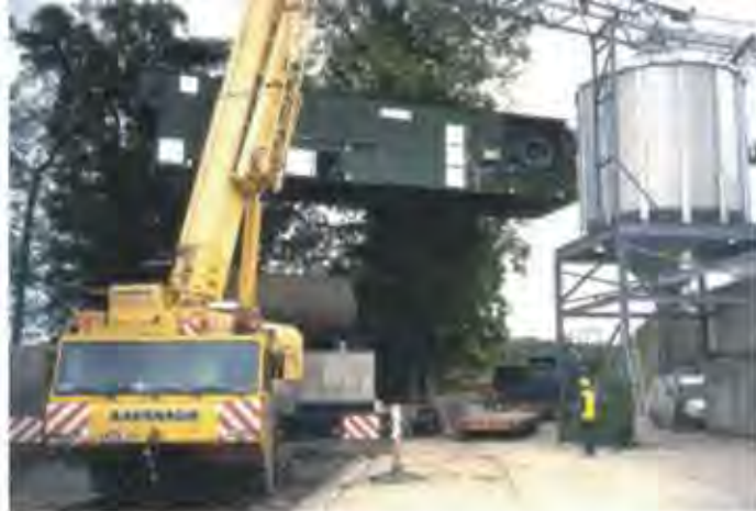
DF 42000 típusú szárítógép fő darabjának leemlése a kamionról és véglegese helyre történő helyezése
