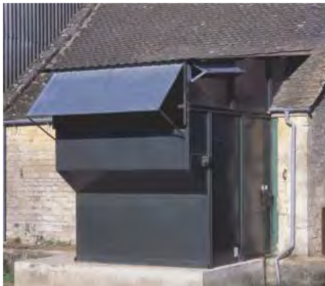
DF 11000-es 12 t/h-s külső beüzemelésű szárító - farmépülethez csatlakoztatva
